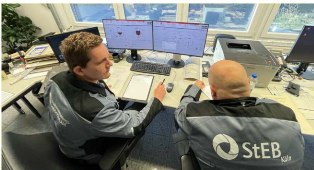
Blick in die Leitwarte der Kläranlage Weiden
