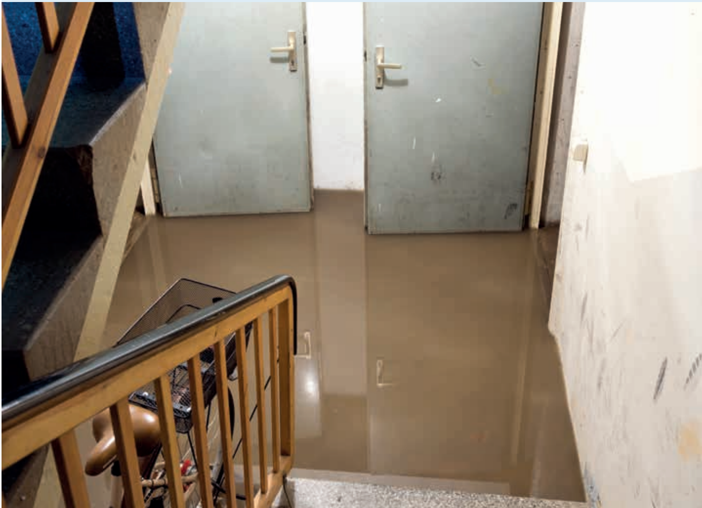
Abb. 37 – Kellerüberflutung nach Rückstau
