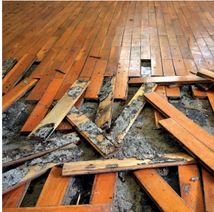
Abb. 48 – Schäden durch Stauwasser
