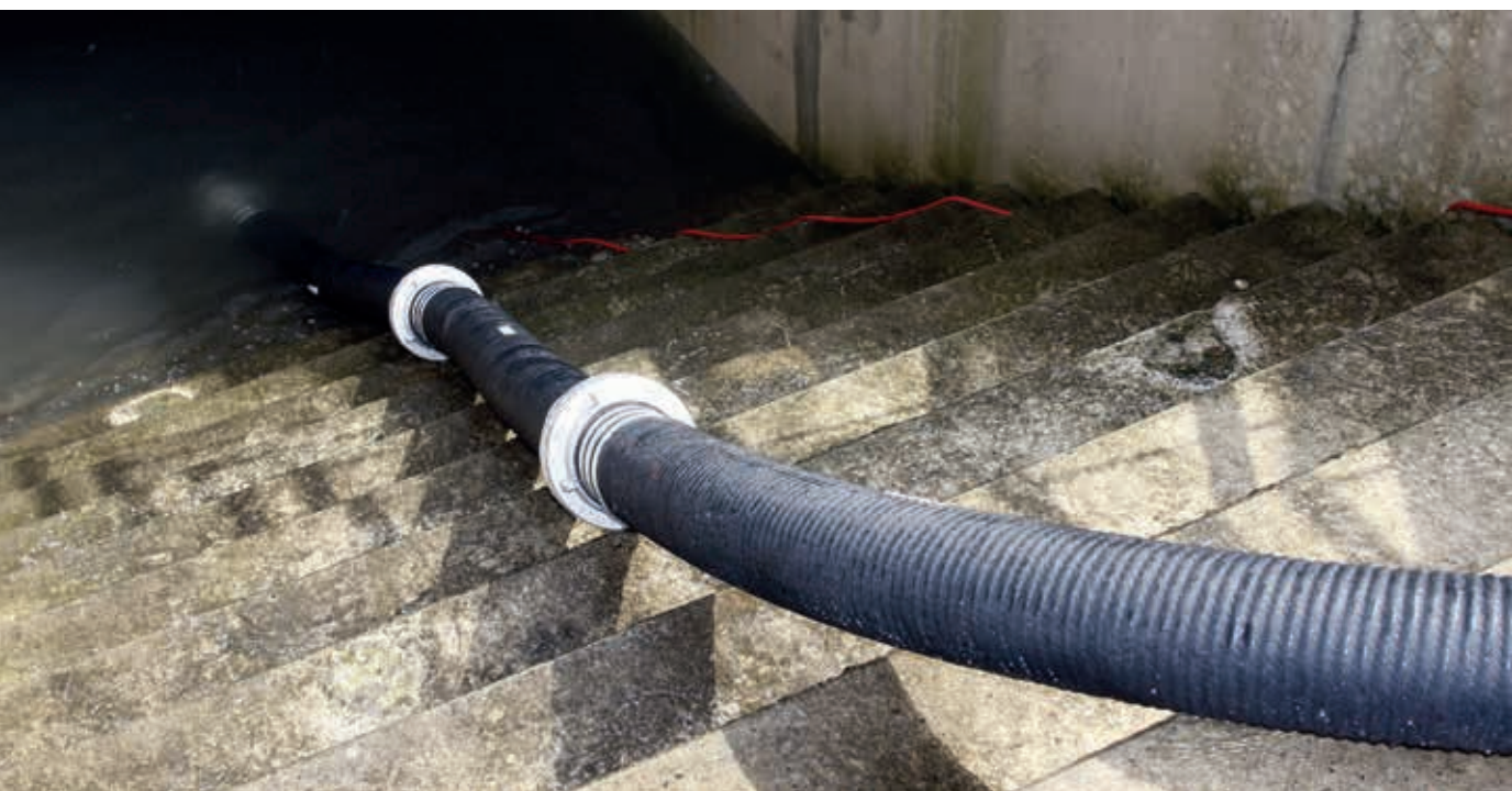
Abb. 2 – Abpumpen eines überfluteten Treppenbereichs
