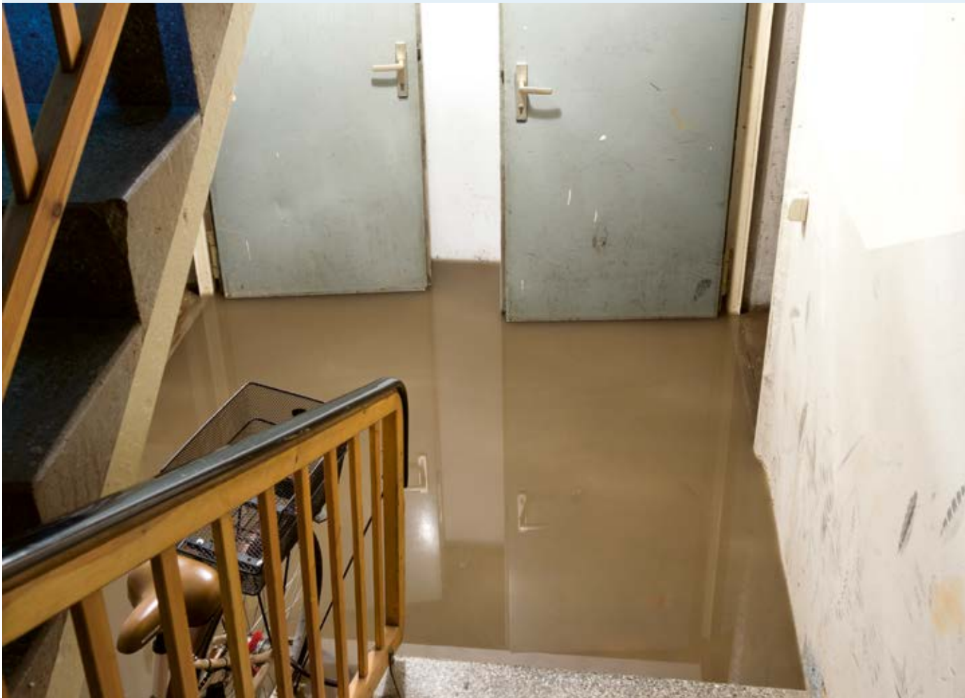
Abb. 37 – Kellerüberflutung nach Rückstau
