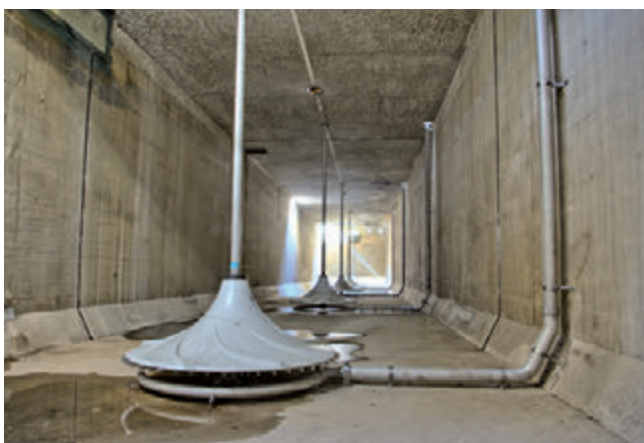
Hochlastbiologie nach Abschluss der Maßnahme
