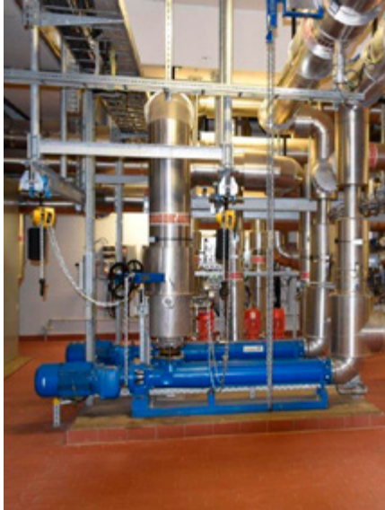
Abzugspumpen für Co-Substrate in den Faulturm
